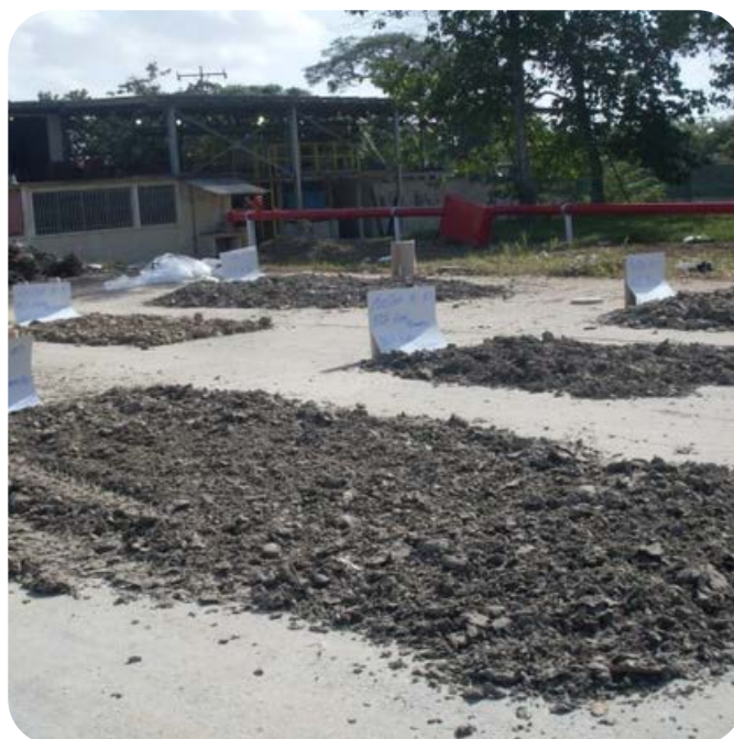
Lodos en cancha de secado
